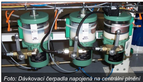
Foto: Dávkovací čerpadla napojená na centrální plnění
