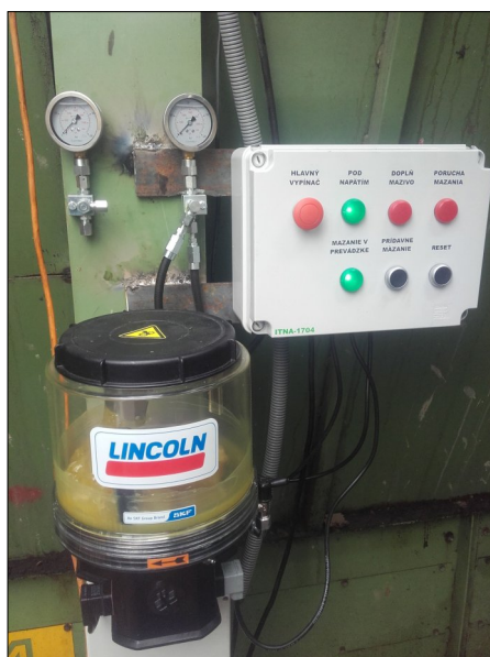
Čerpadlo P203 s autonomním řídicím systémem
