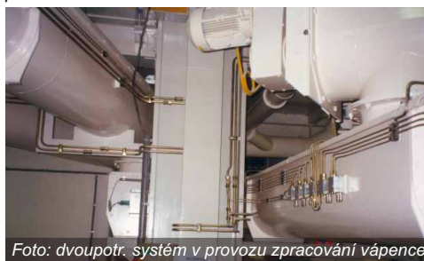
Foto: dvoupotr. systém v provozu zpracování vápence
