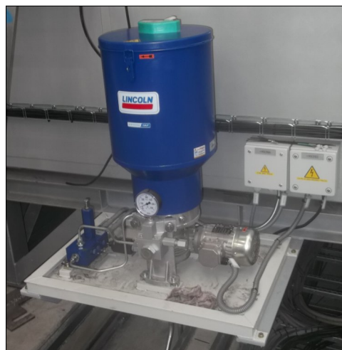
Čerpací stanice s čerpadlem ZPU 02 s příslušenstvím a přeřazovačem větví DU1-GKS
