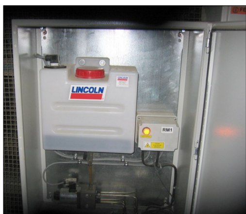
Rozváděčová skříňka s čerpadlem PMA, olejovým zásobníkem a elektroovládáním
