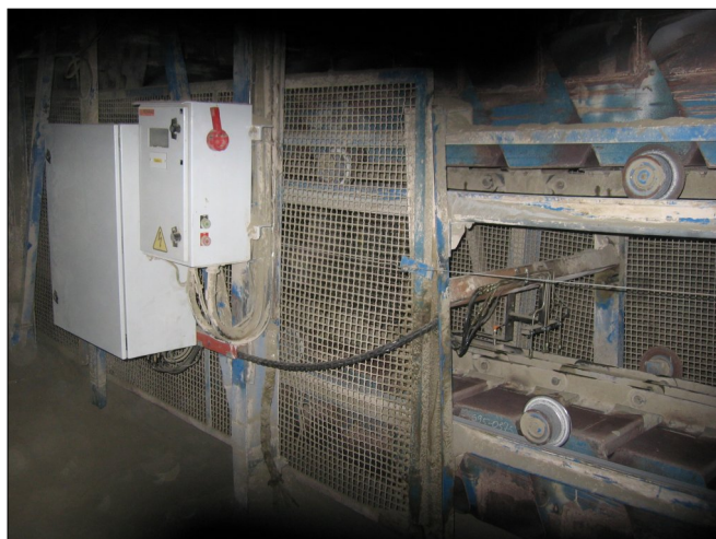
Celkový pohled na mazací systém
