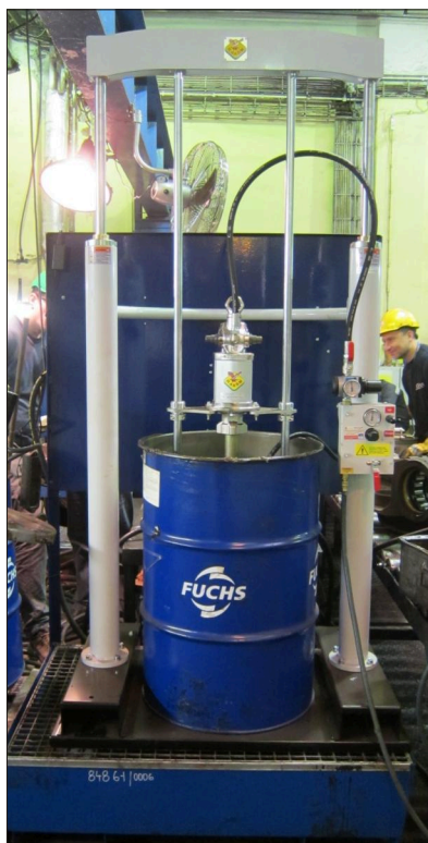
Čerpací stanice. Panel ze sousední fotky je otočen zády.
