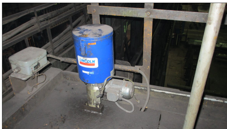
Čerpadlo P205 umístěné na rampě jeřábu
