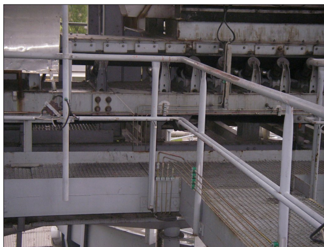
Rozvody maziva z ocelových trubek - od čerpadla k sekundárním rozdělovačům
