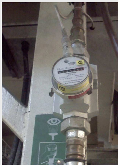
původní měření průtoku turbínkou
