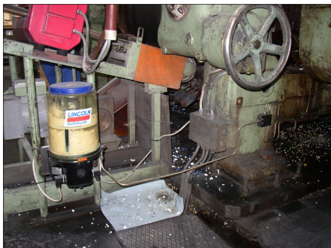
Čerpadlo P203 s progresivním rozdělovačem SSV-N 8/4
