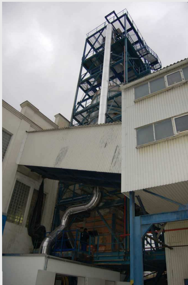
Potrubí nasávaného vzduchu
